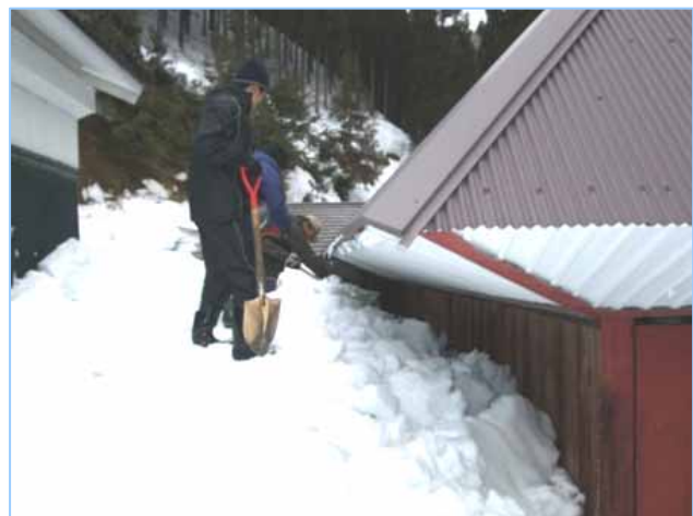
トタン屋根の住居の除雪ボランティア（立命館大学ワークキャンプ 平成24年2月）
